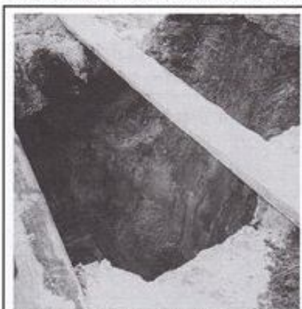
7 lipca br. podczas kopania tego grobu ziemnego rodzinnego na Komunalnym Cmentarzu Północnym w Warszawie ziemia przysypała pracownika w wykopie o głębokości 2,5 m. Na szczęście, skończyło się tylko na strachu. Osunięcie ziemi nastąpiło prawdopodobnie na skutek niepełnego szalunku wykopu.
